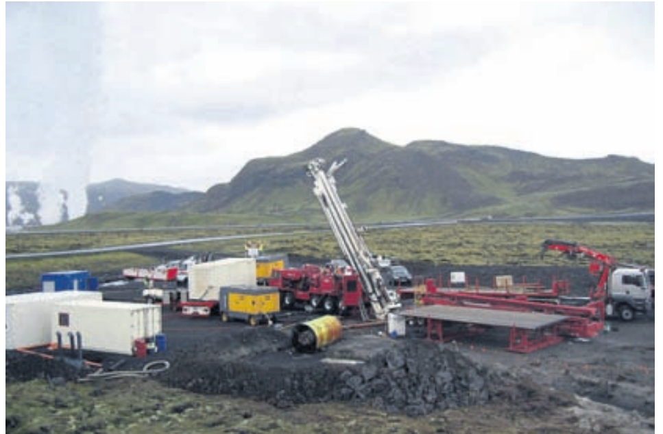
Borinn NASI að bora skáholu fyrir Orkuveituna á Helliðarvirkjun haustið 2008. Nýlega lauk hann við að bora 1.606 m djúpa holu við Hoffell við Hornafirði. Verkið var unnið fyrir Rarik með góðum árangri.
