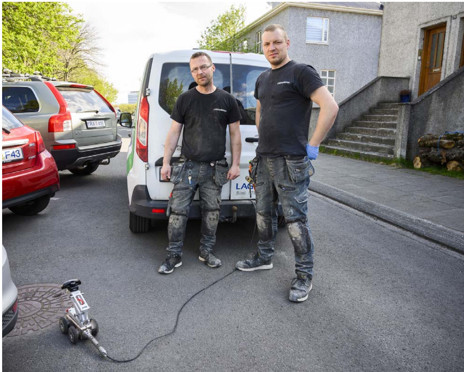
Þegar leysa þarf úr óvæntum vandamálum eru starfsmenn Lagnafóðrunar snöggir að mæta á staðinn. FRÉTTABLAÐIÐ/SIGTRYGGUR ARI
