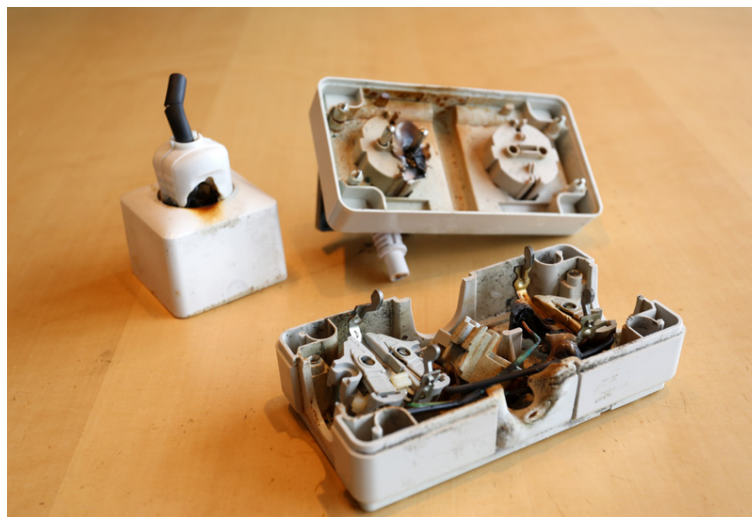
Það er mikilvægt að stinga ekki rafbilum í samband í venjulega innstungu. Þessi tengill er 13 amper. Það kviknaði í honum eftir að hann var notaður við hleðslu rafbíls. FRÉTTABLAÐIÐ/VALLI
