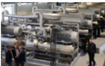
Varmadælistöðvar fyrir þá sem ekki eiga kost á að nýta jarðvarma til húshitunar.
