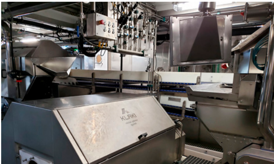
■ Vinnslukerfið á þilfari skipsins er frá Klaka ehf.
