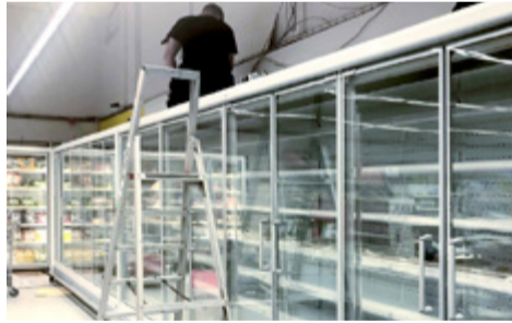
Uppsetning, þjónusta og viðgerðir fyrir matvöruverslanir ásamt 24/7 tíma vöktun.
